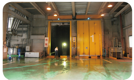
稼働中の焼却炉
