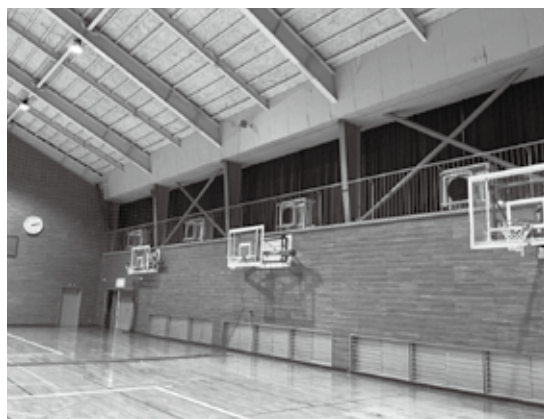
加賀中学校体育館エアコン
