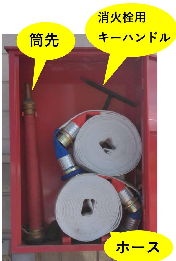
【消火栓ホース格納箱の中】
