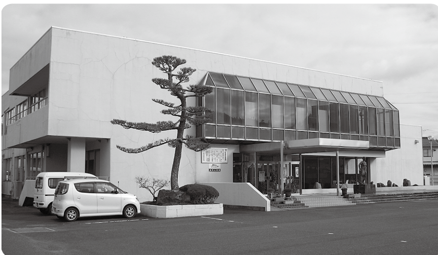
目立つひび割れ 公民館
